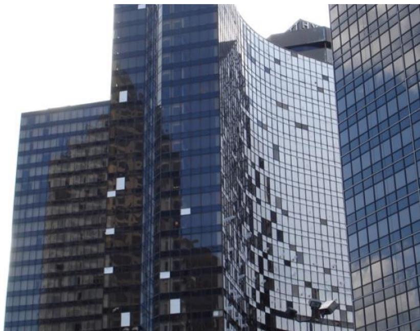
高層建築物のガラスの破損
