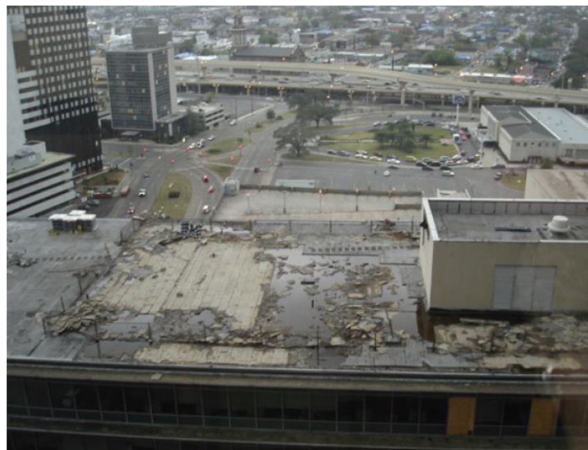
屋上のコンクリート板の飛散
