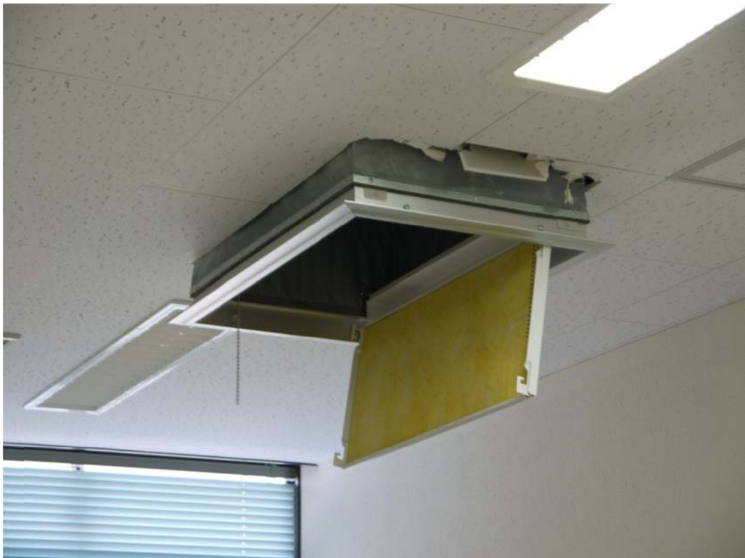
センター棟 3階個室。エアコンのダクトが脱落しています。〈撮影：3月14日（月）10:05〉
